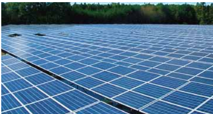
▲ 佐藤石材桜川太陽光発電所(茨城県桜川市)
