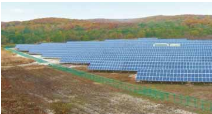
▲ 苫小牧植苗太陽光発電所
